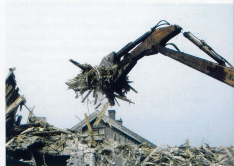
Gravemaskinene tar store jafs av kanalhusene på Smieøya. Foto: Tor K. Gardåsen.
