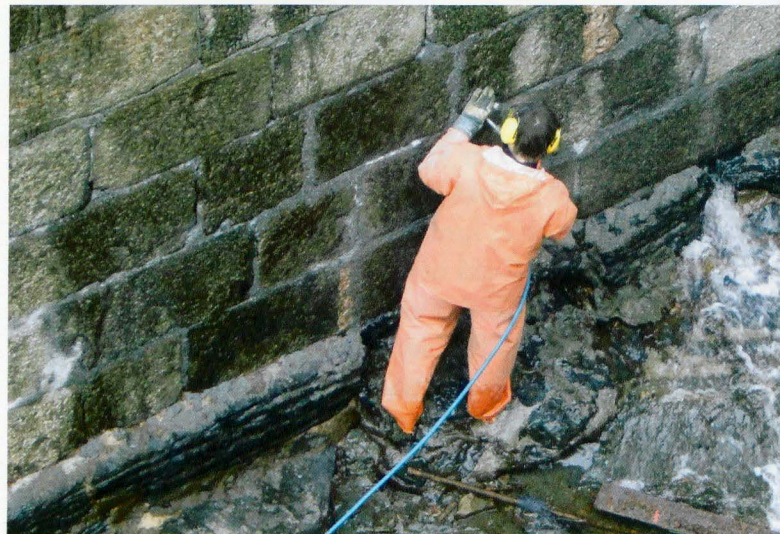
Slusevokter Thomas Kittelsen i gang med å fjerne gamle og løse spekkefuger. Resultatet ble meget bra. Til og med den gjenstridige lekkasjen mot mølletomta fikk vi bukt med!
