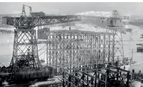
Store kraner, tunge løft: I de første årene kom det aller meste, stort og smått, sjøveien til Notodden. Kranene måtte kunne ta imot både jernbanevogner, lokomotiver og deler til Tinnosjøferjene. Foto: Norsk Hydro/NIA 5911.
